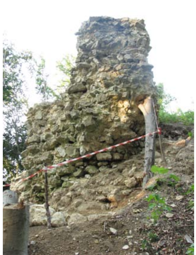
Abb. 12: Burgruine Ried am Riederberg. Vom Absturz gefährdeter Mauerkern. Oliver Fries, 2009.
